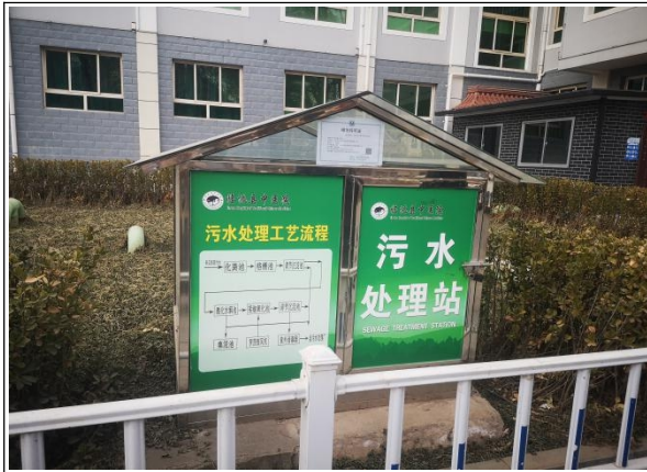
医院污水处理站
